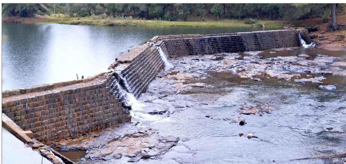
Figura 6 - Estado atual da barragem-vertente. Imagem: RECITECH, foto de 14.mai.2020.
